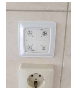
Standenschakelaar in keuken
