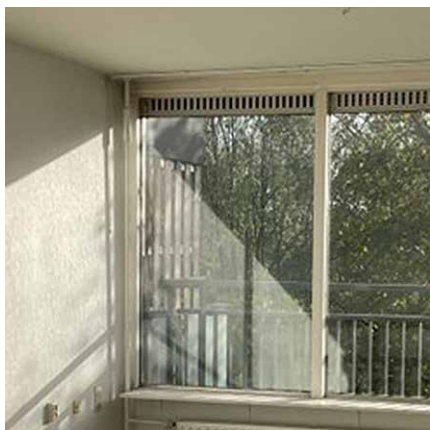
Bestaande roosters in de woning
